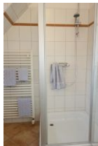
Die Duschkabine und Handtuchheizung
