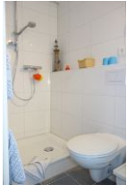
Die Dusche und Toilette, nicht im Bild das Handwaschbecken.
