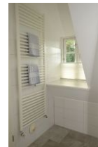
Auch hier die Handtuchheizung
