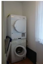
Im Hauswirtschaftsraum zur kostenfreien Nutzung; Waschmaschine und Trockner.
