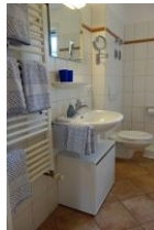
Das Bad mit Handwaschbecken, Handtuchheizung, Toilette....
